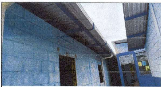
Foto 5: Sustrucción de canal de metal
